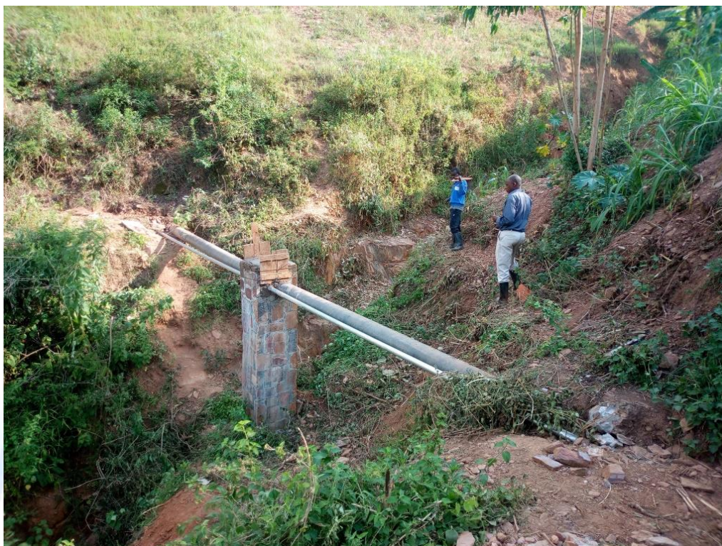
Condotta sospesa in zona di alta erosione causa calanchi piovani
