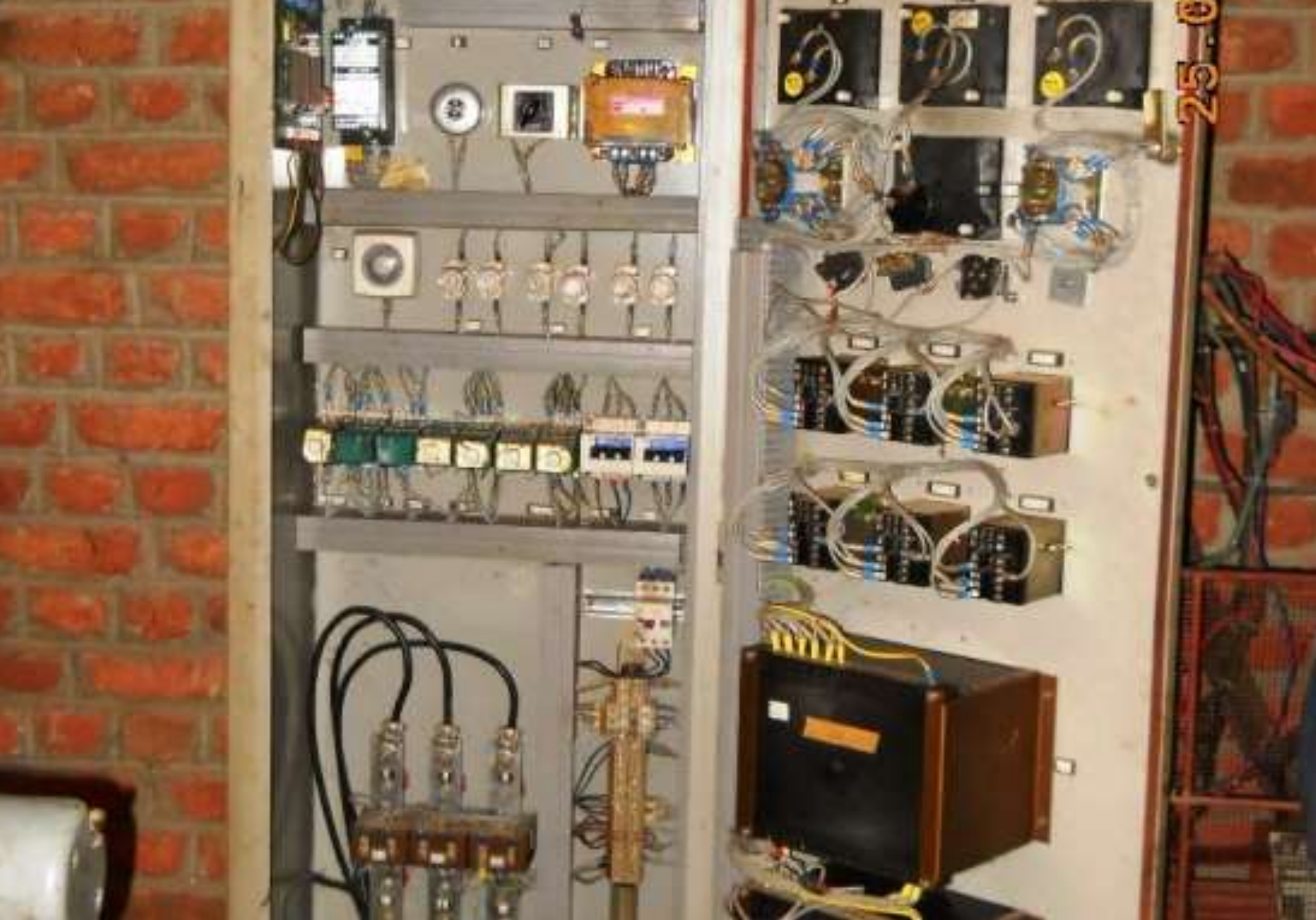
quadro di comando
