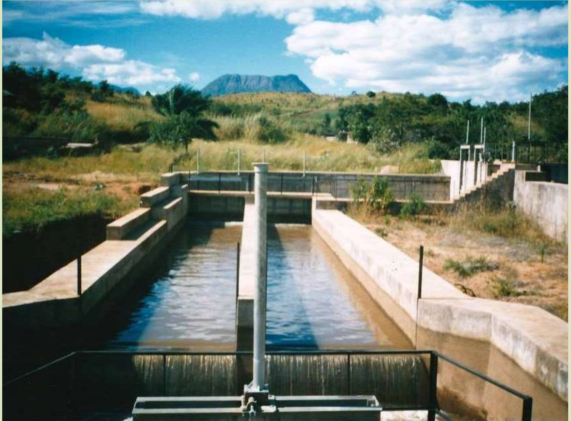
bacino di decantazione
