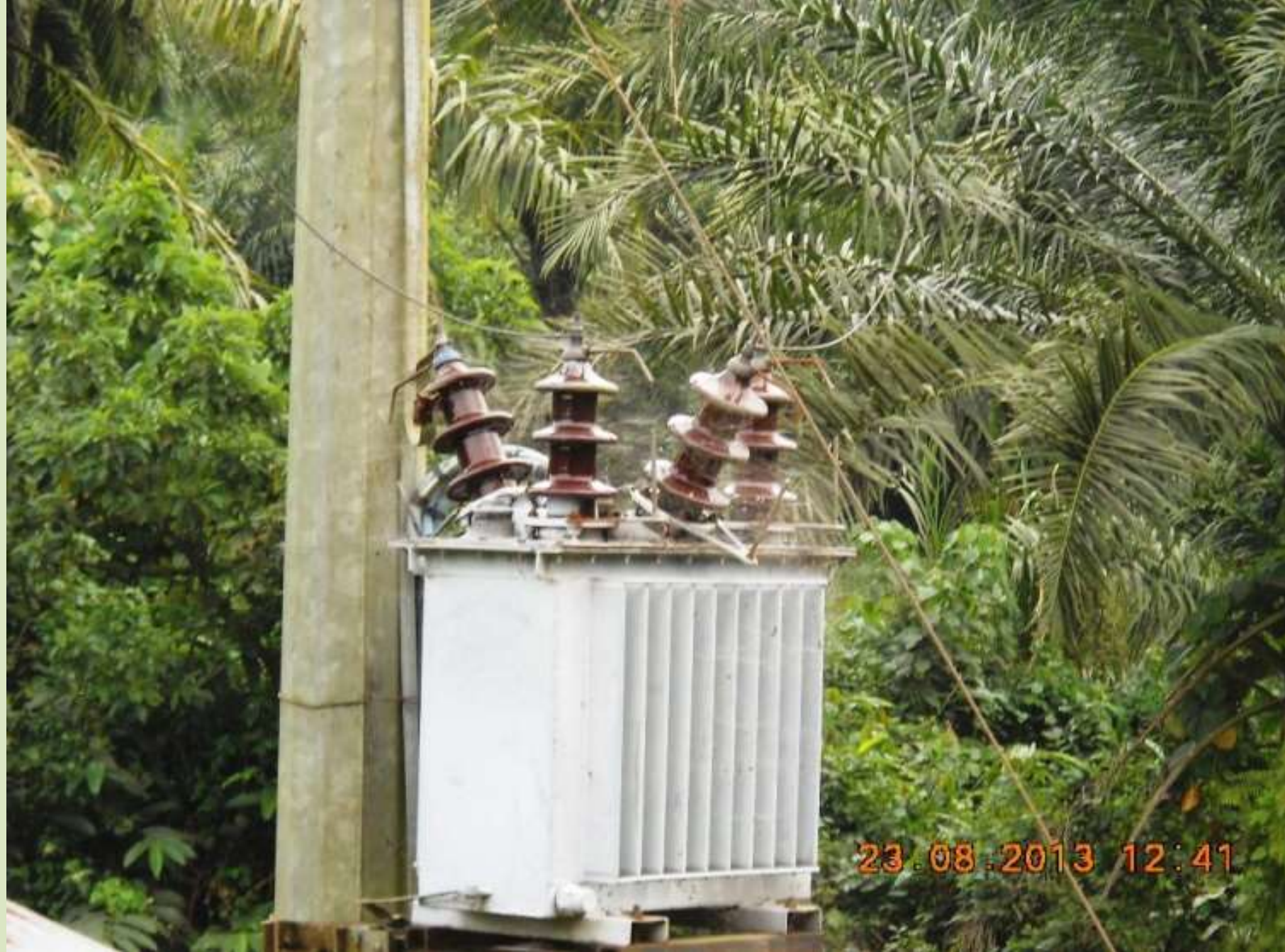
Trasformatore inizio linea
