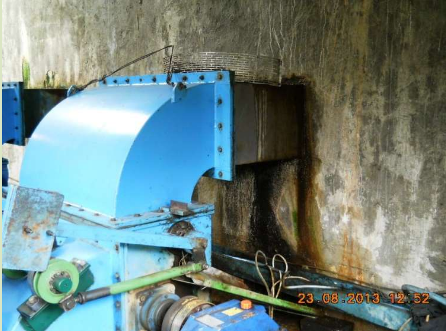
gruppo generatore presa acqua
