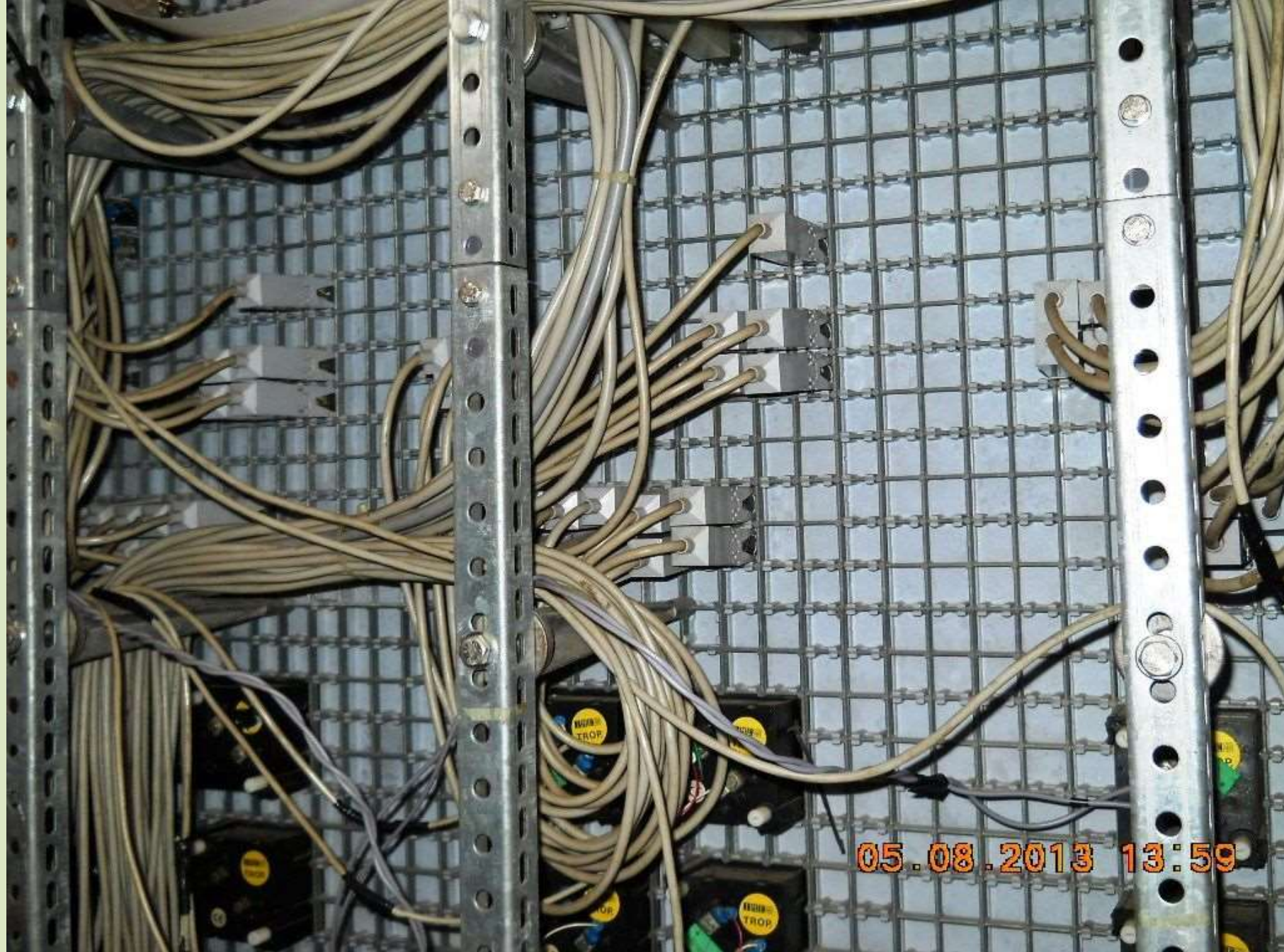
dettagli quadro comando
