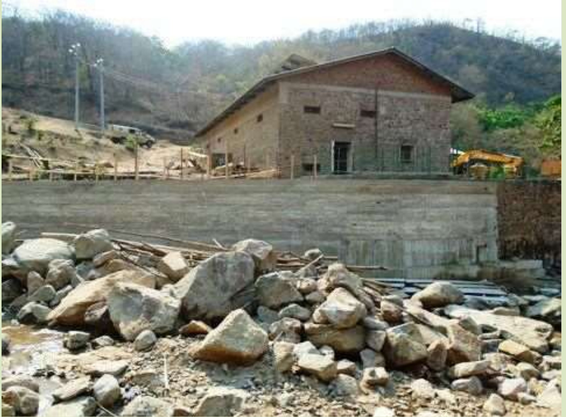
muro di protezione dopo piena fiume
