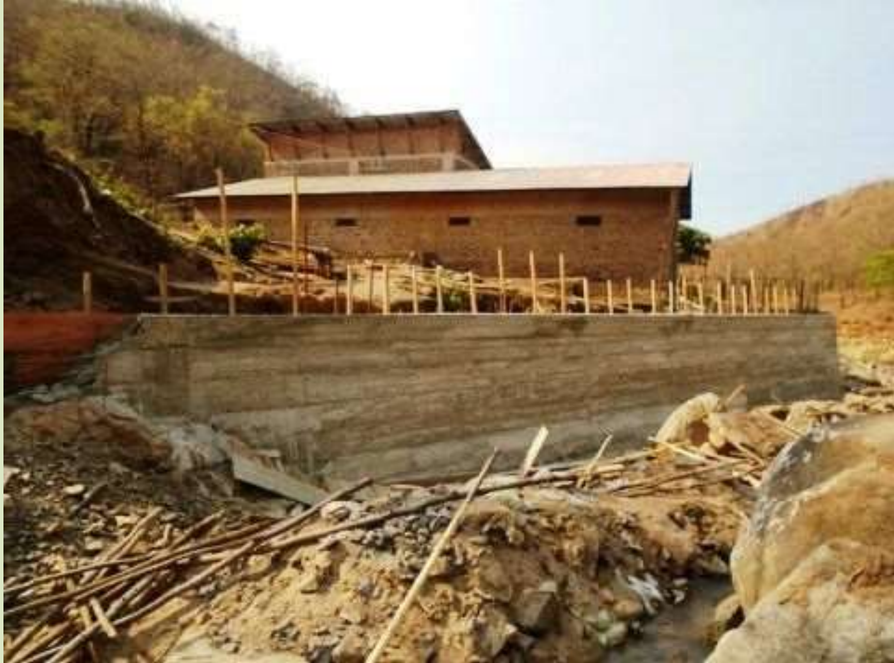
muro di protezione dopo piena fiume
