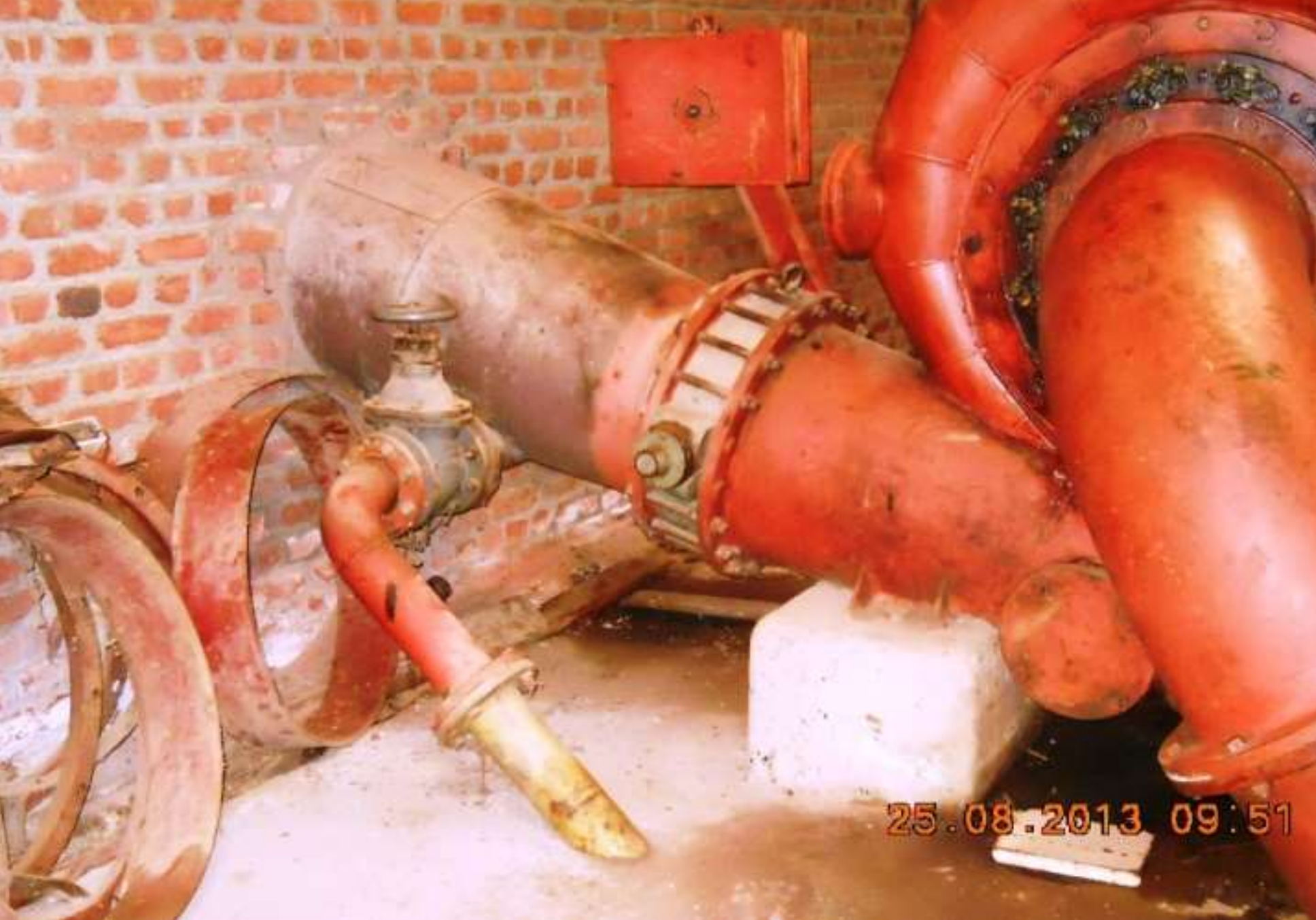
Carico acqua in turbina
