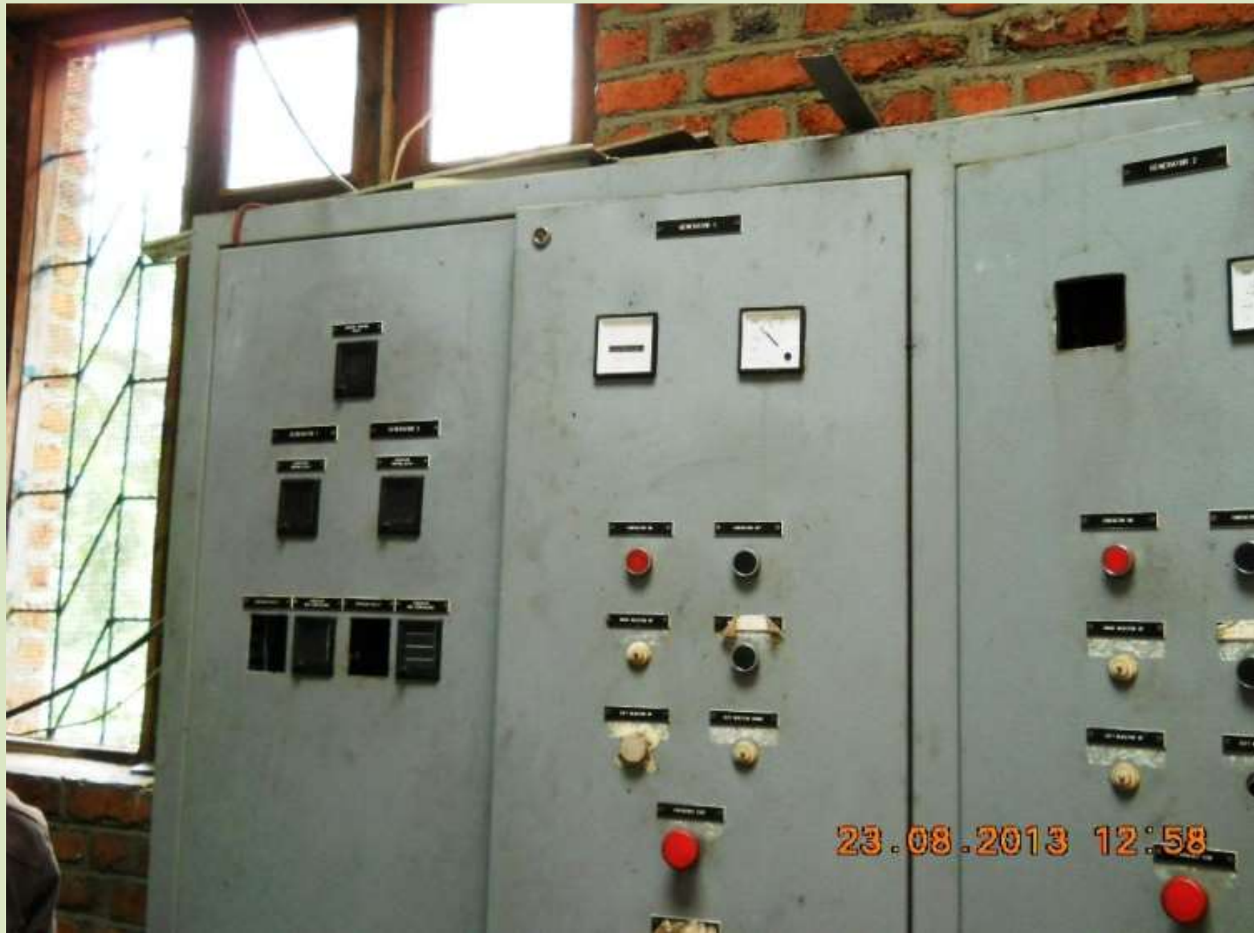
quadro di comando
