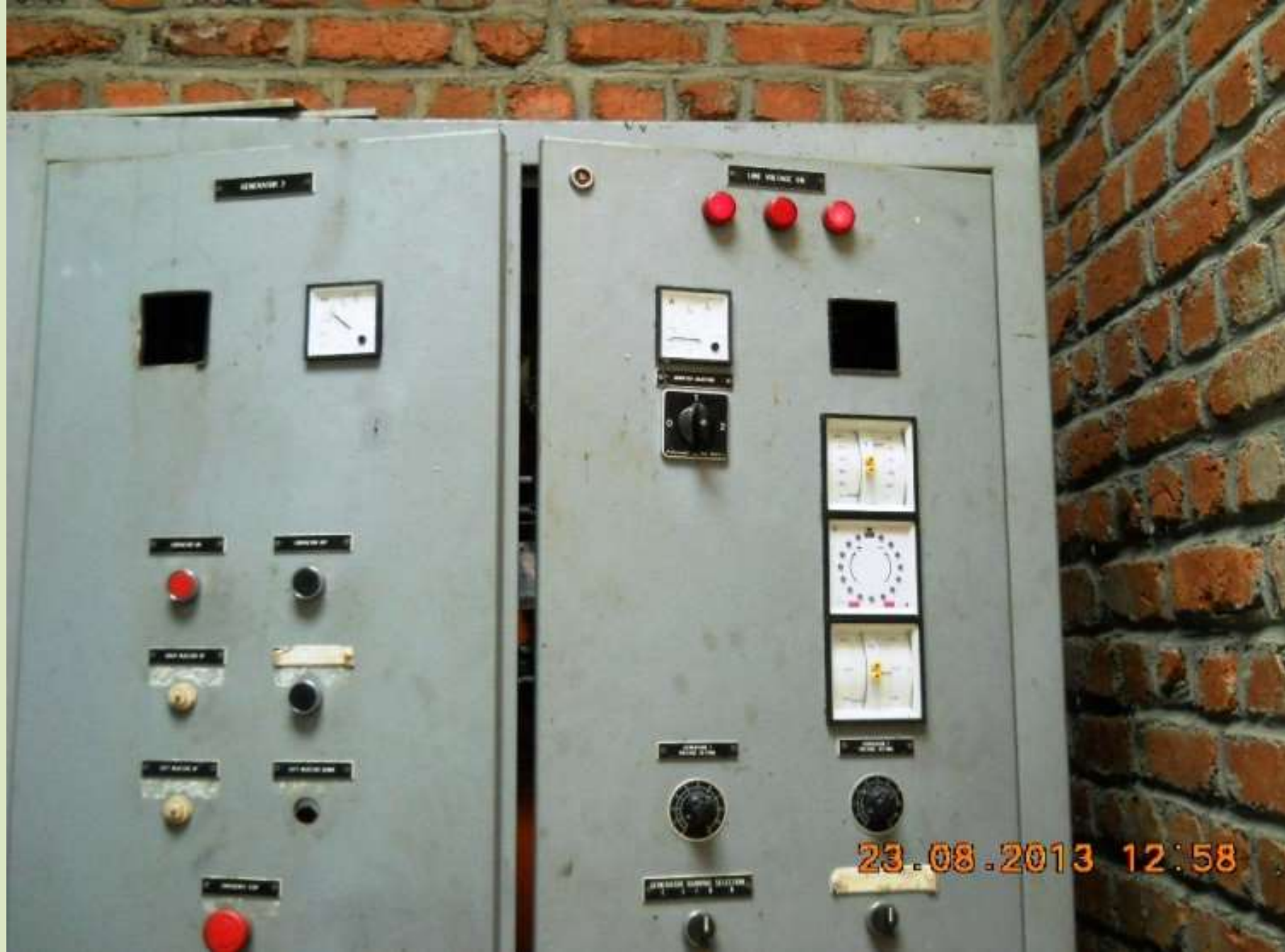
quadro di comando
