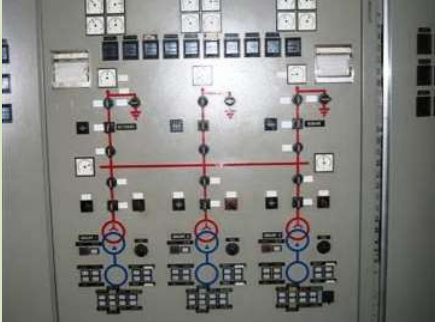
quadro di comando
